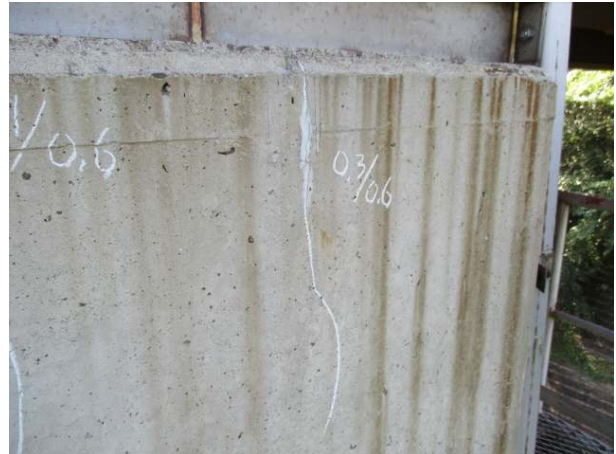
P1 교각 균열(0.3mm이상)
