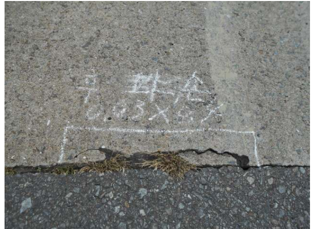
A1 후타재 파손
