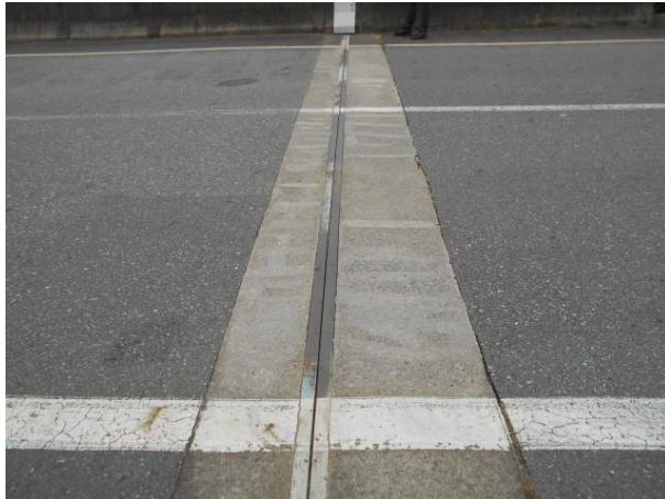
A1 후타재 균열(0.3mm미만)
