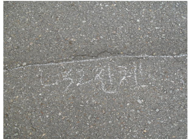
S2 아스콘 균열
