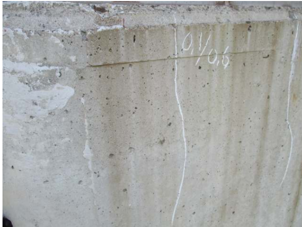
P1 교각 균열(0.3mm미만)
