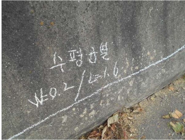
S1 연석 균열(0.3mm미만)
