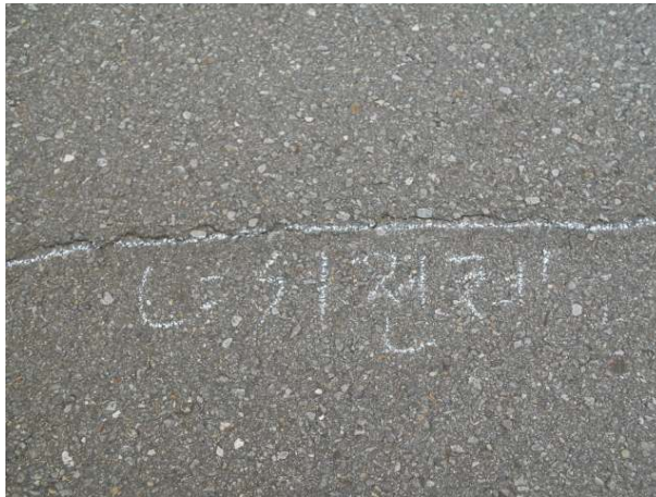
S1 아스콘 균열
